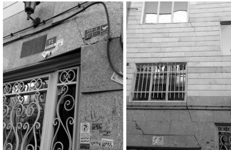
■ تصویر شماره ۱۴: کیفیت نامطلوب ساخت
